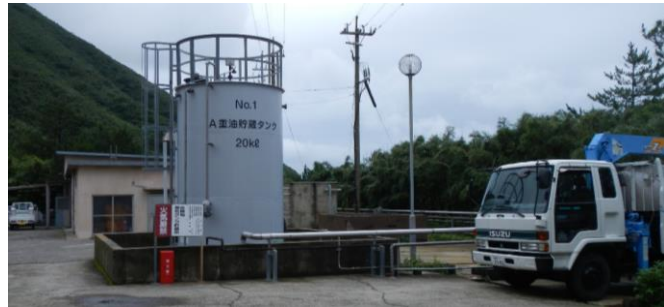
写真-3 硫黄島内燃力発電所 （奥の建物が発電所。前面に 20kℓ重油タンク、燃料運搬車両）
