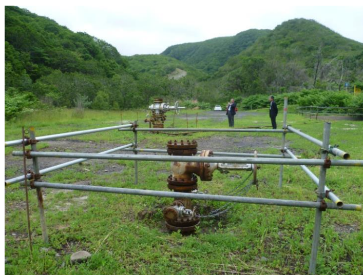
写真-7 ②離島の地熱情報の調査 (平成19年度促進調査奥尻西地域 N18-OW-1, N19-OW-3 掘削地点)
